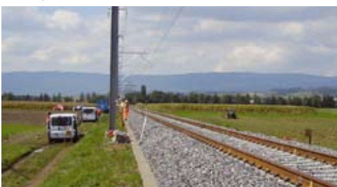
Für die Messungen wurde ein 160m langer Streckenabschnitt entsprechend den Normanforderungen auf UIC-60-Schienen und Betonschwellen umgebaut.
