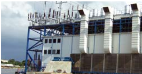
Sicht auf das Schwimmkraftwerk Sultana del Este
