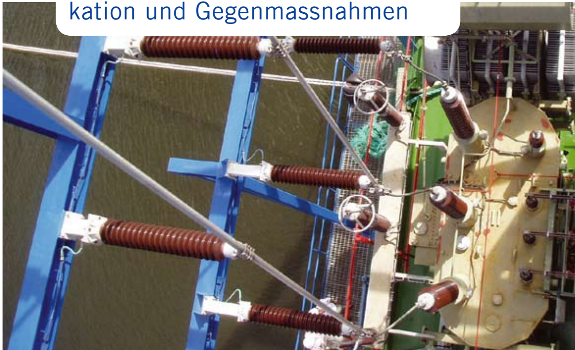
Einer der drei Transformatoren des Schwimmkraftwerk Sultana del Este mit den Hochspannungsanschlüssen
