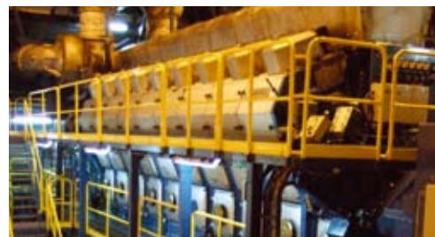
Dieselmotoren und deren Lagerung im Maschinenraum
